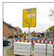
Die Arbeiten für eine Fußgängerampel auf der Warendorfer Straße in Höhe Einmündung Rote Erde im Oelder Norden haben begonnen. In knapp zwei Wochen soll die Ampel in Betrieb gehen. Bild: re
