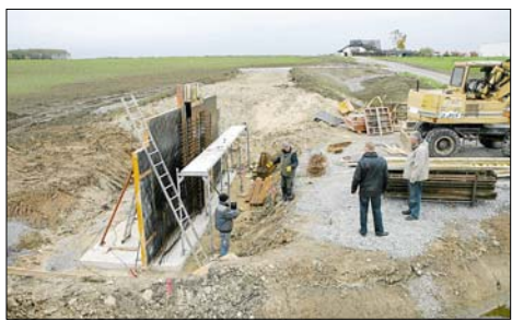
Ein Rückhaltebecken mit Regeltechnik entsteht zurzeit an der Küttelecke am Rande des Oelder Gewerbegebietes A 2. Bilder: Reimann
