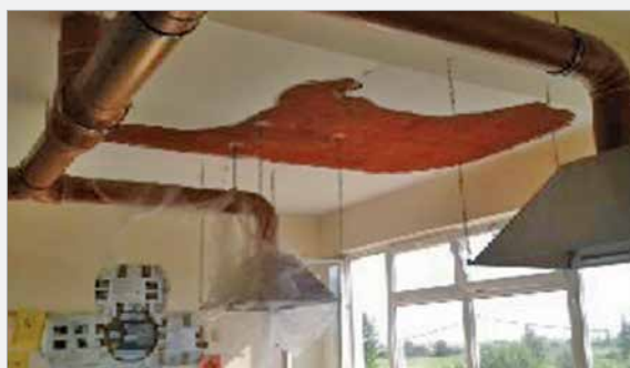
Schäden im Deckenputz
